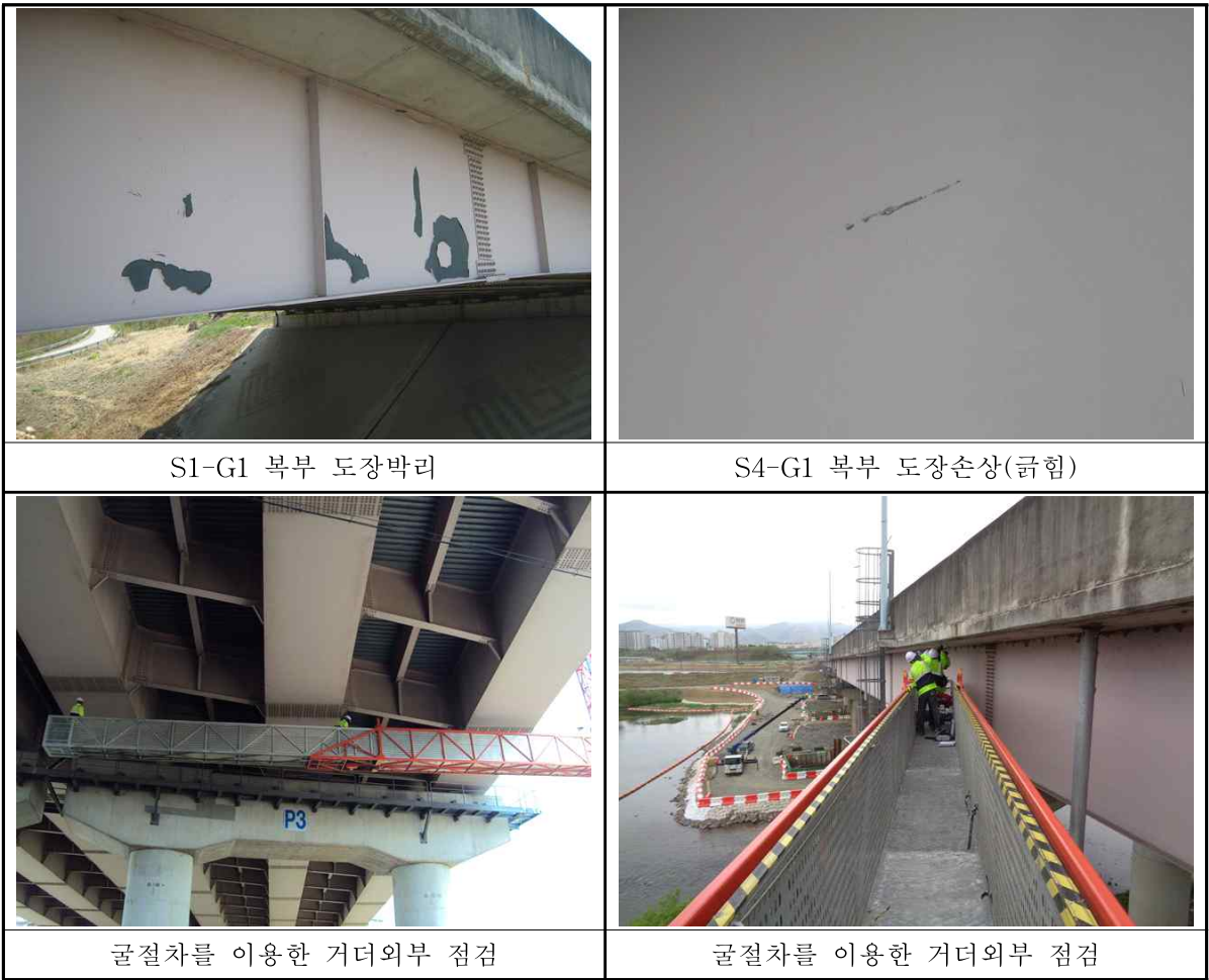
<표 3.2> 범물방향 거더 외부 외관조사 결과
