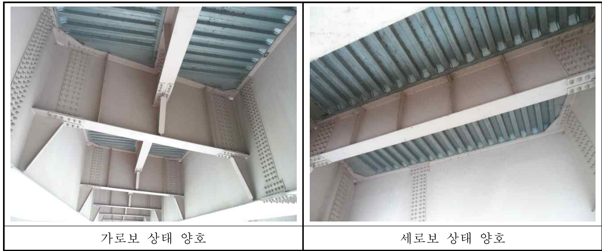
<표 3.6> 범물방향 가로보 외관조사 결과
