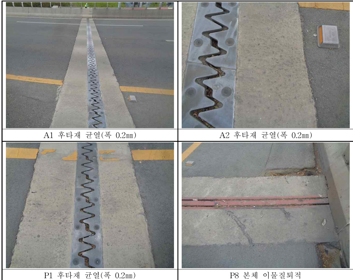
<표 3.17> 범물방향 신축이음 외관조사 결과
